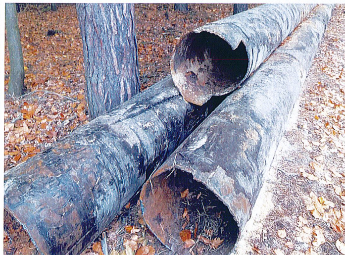
Wyeksploatowany i awaryjny stalowy rurociąg przesyłowy doprowadzający wodę surową do Stacji Uzdatniania Wody w Strzyżewicach.
