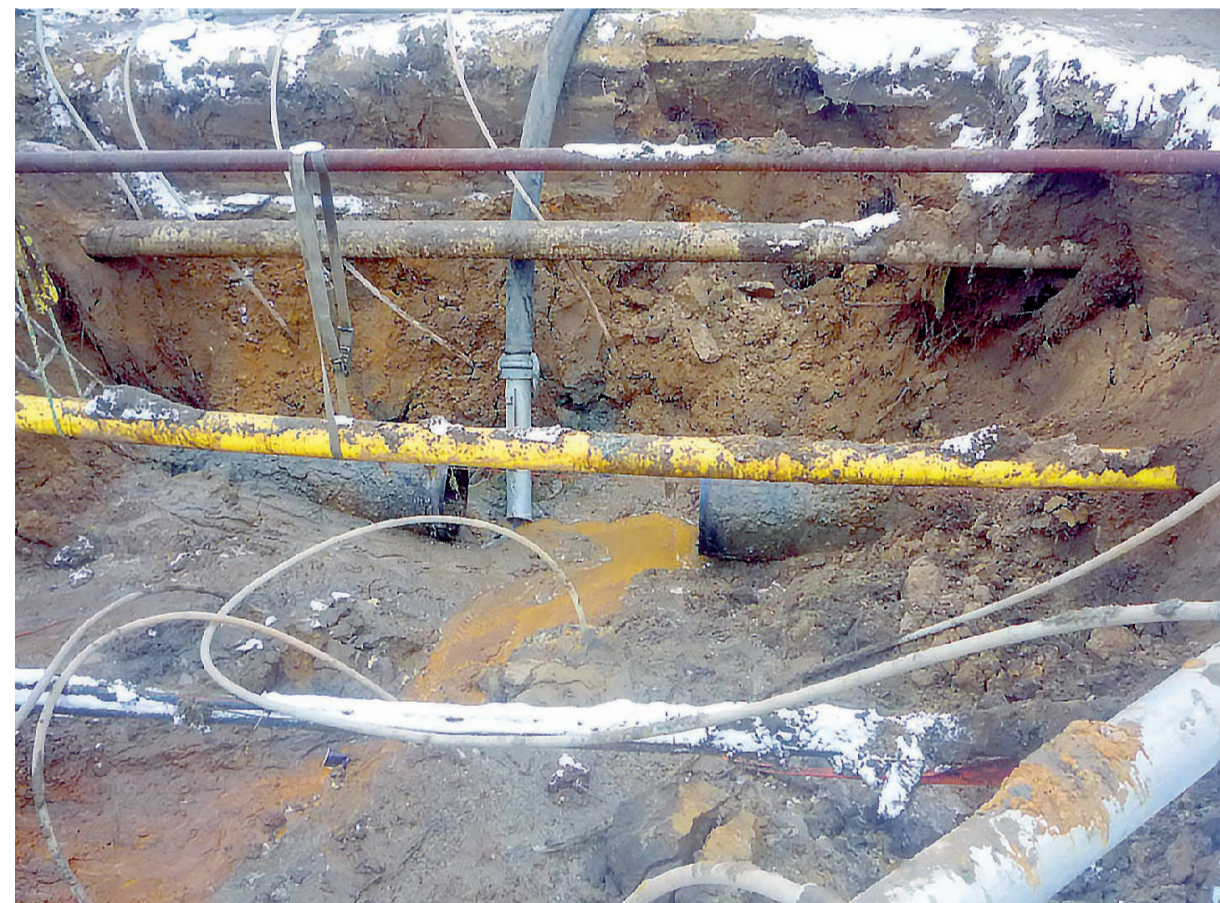
▲Awaria, która miała miejsce w 2012 roku na ulicy Fabrycznej. Zdjęcie z zasobów archiwalnych MPWiK Sp. z o.o. w Lesznie.
